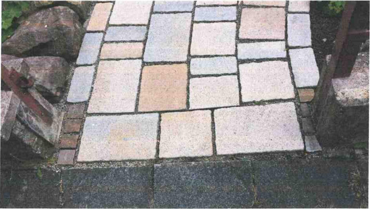
Bild 8: Oberer Garteneingang (Hintereingang von der Straße „Hinter den Höfen“ aus), Zustand vor der Baumaßnahme
